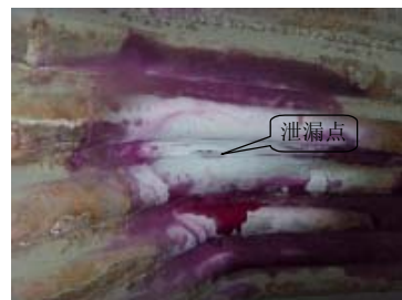
图9 锅炉转角鳍片与管子角焊缝泄漏
