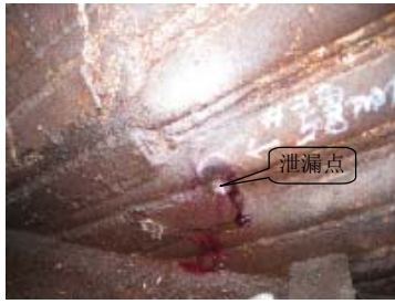
图 12 填板端头与管子角焊缝泄漏
