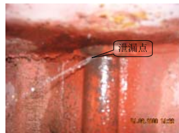
图10 刚性梁与管子角焊缝泄漏
