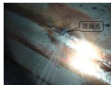
图11 制造厂对接焊缝泄漏
